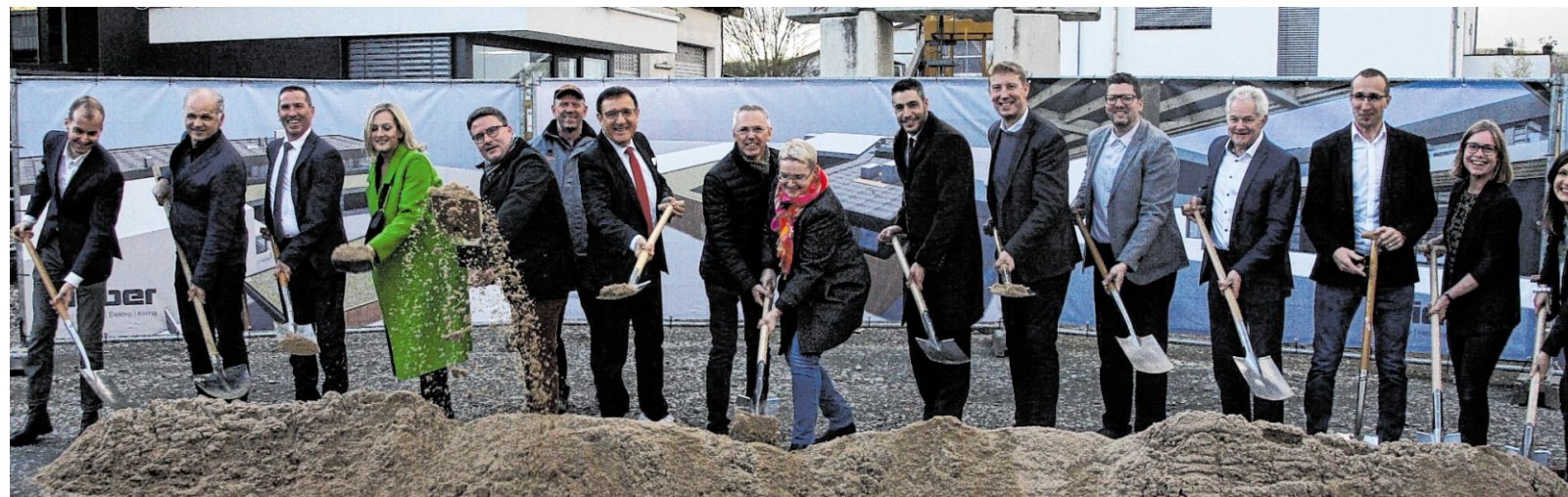
Gemeinsam mit zahlreichen Ehrengästen, Geschäftspartnern und Vertretern der baubeteiligten Unternehmen feierte die Hieber AG in Weikersheim bei einem symbolischen ersten Spatenstich den offiziellen Baustart für eine neue Lager- und Logistikhalle.
